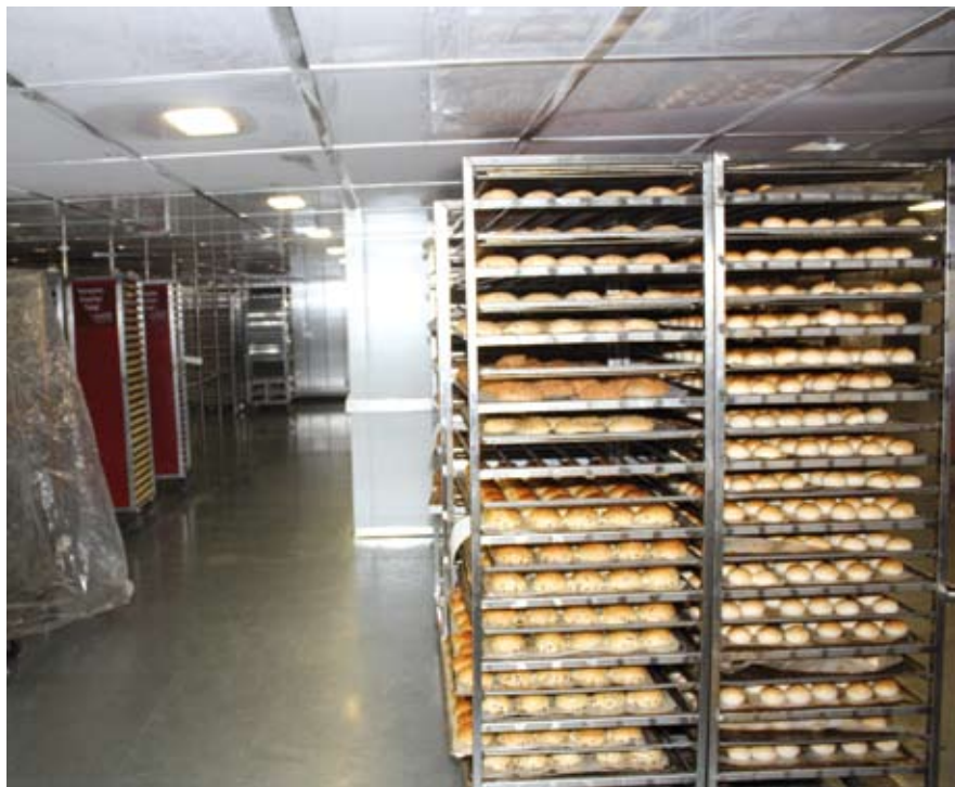
Die wegen des direkten und schnellen Zugangs zentral in der Mitte der Produktionshalle angeordneten Kälteanlagen stammen von Koma.
